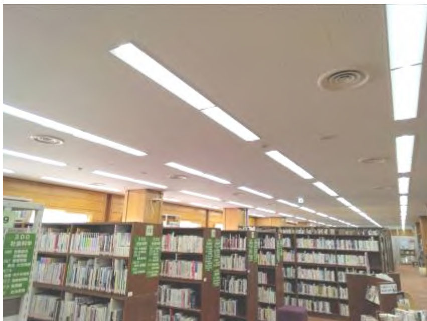
↑LED照明となり明るくなりました
